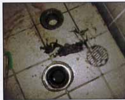
排水口トラップ内に髪の毛等あり
