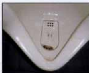
破損したトラップ目皿
