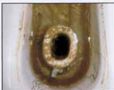
排水管内に尿石固着
