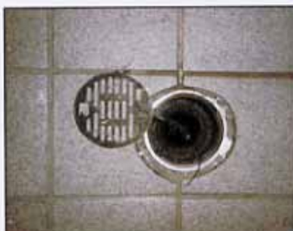
排水口トラップ内に水が入っていない
